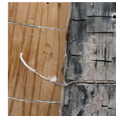
外部表面材厚50mmの耐火構造の性能により、耐震構造部材は影響を受けていない。
